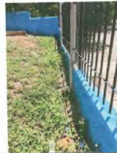
Foto 4: Se observa las malas condiciones del desagüe y cuneta dentro del perímetro del establecimiento.
