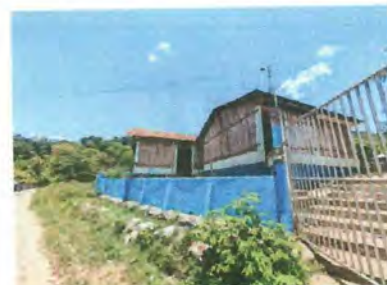
Foto 6: Se observa las malas condiciones de la cubierta de las aulas. El deterioro de las paredes improvisadas.
