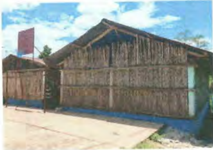
Foto 1: Se observa las malas condiciones de la estructura portante de las 2 aulas del modulo 2.
